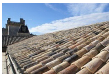
3e tranche des travaux de la toiture de l'hôtel de ville terminée en 2011
