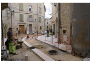
L'évacuation des eaux pluviales au centre
