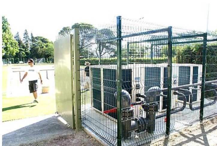
Nouvel équipement de trois pompes à chaleur
